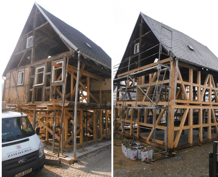
Ansichten der Ost- und Nordseite nach Ausbau des Mauerwerks (links) und Rekonstruktion der Fachwerkaußenwände (rechts)
