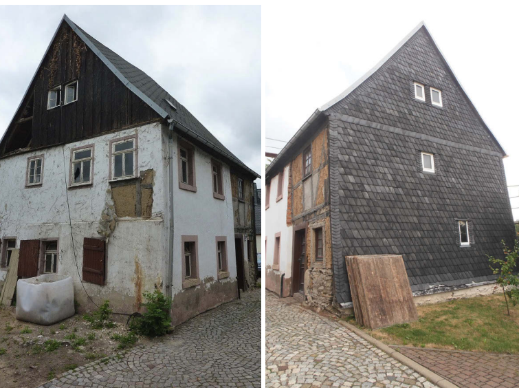
Ansichten der Ostseite (links) und Westseite (rechts) im Jahre 2018, vor Beginn der Instandsetzung
